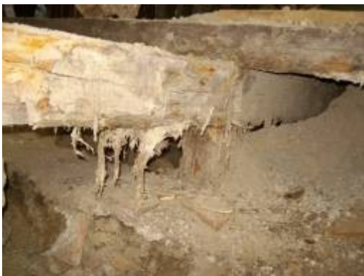
4. sz. fotó: A padló elgombásodott tartószerkezete (Máthé Zs.)
